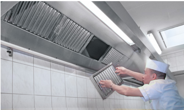
Herausnahme der X-CYCLONE® Abscheider aus einer Ablufthaube.
