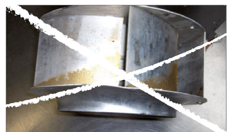
Abb.: Ansichten einer nicht gepflegten Ventilatereinheit
