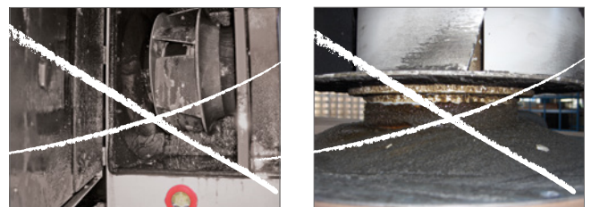
Abb.: Innenansichten eines nicht gepflegten Gerätes
